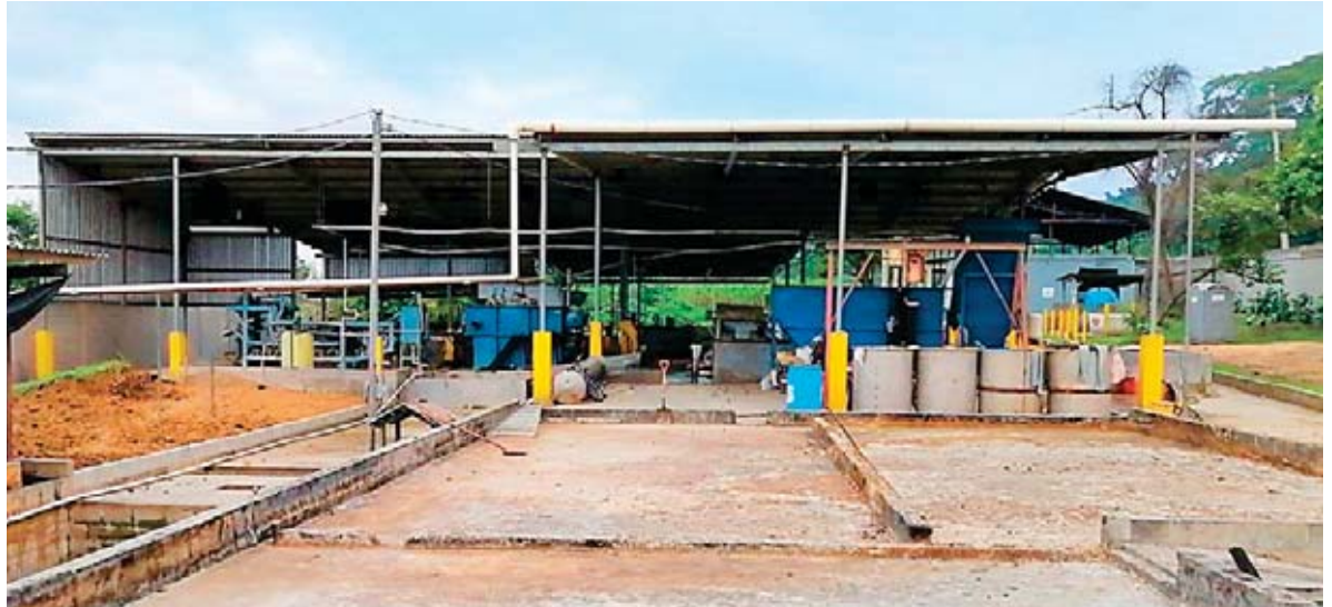
La planta de tratamiento cuenta con todos los requerimientos.
