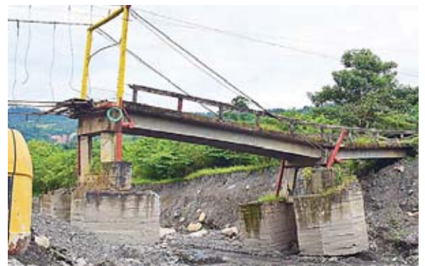
Hace diez años el puente fue destruido por las corrientes de invierno.
