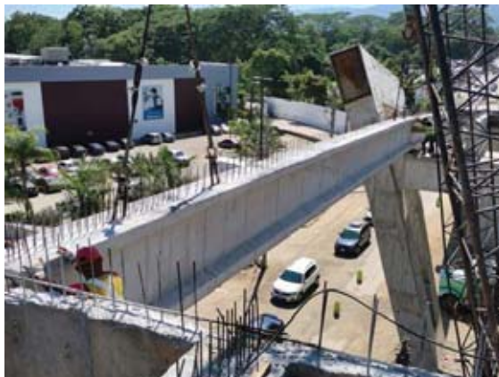
Luego de fundir las losas se colocarán las medias barreras y las barandas.
