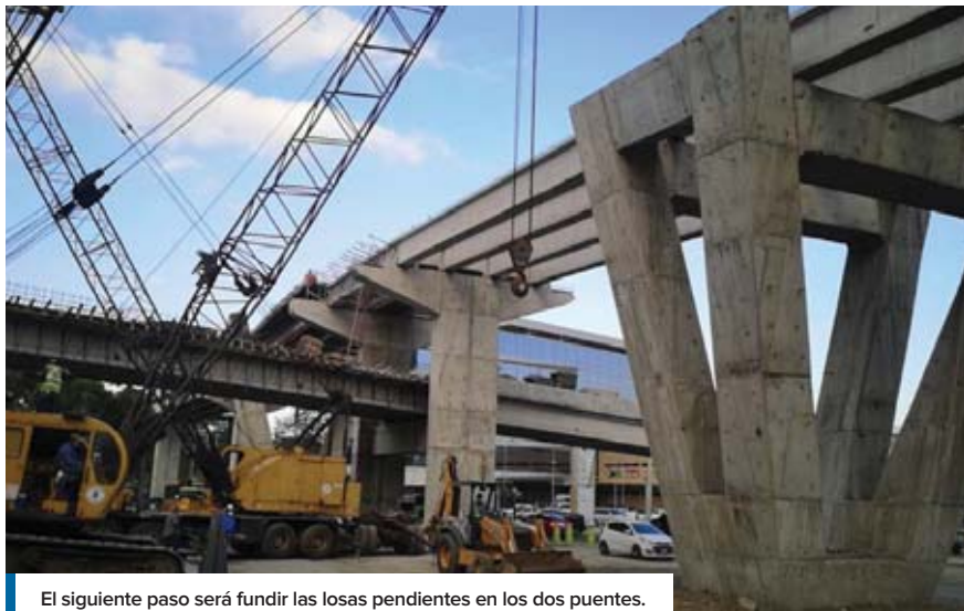
El siguiente paso será fundir las losas pendientes en los dos puentes.
