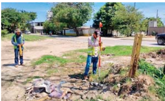
La obra inició con trabajos de topografía. La primera parte del proyecto se enfocará en construir los sistemas de aguas lluvias y aguas negras.
