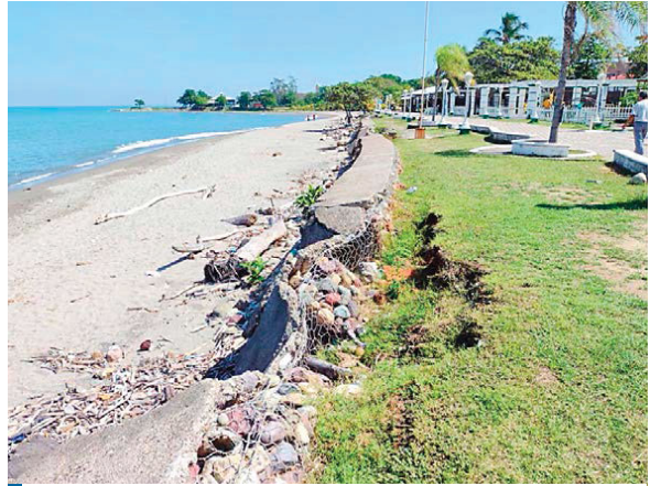
El malecón de La Ceiba se ha destruido producto del oleaje, las autoridades locales no han hecho nada por restaurarlo.
