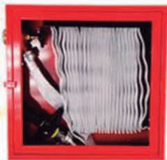
GABINETES CON MANGUERAS
