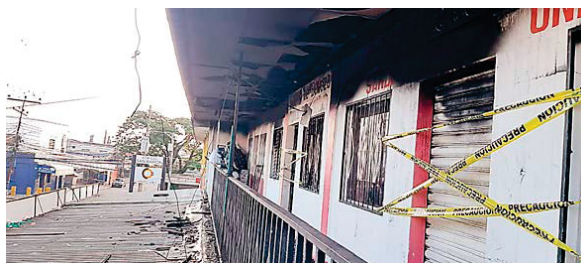
Según indicaron locatarios, las pérdidas son millonarias. Técnicos trabajaban ayer para determinar las causas.
