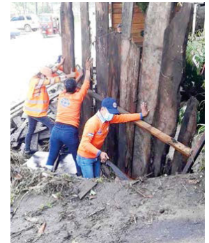
Personal de Copeco, realizó labores de limpieza en las diferentes zonas que resultaron afectadas.
