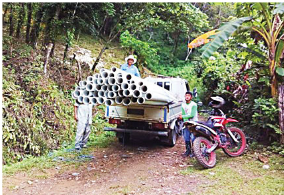
Gran parte de la tubería resultó destruida por lo que fue necesario cambiarla.
