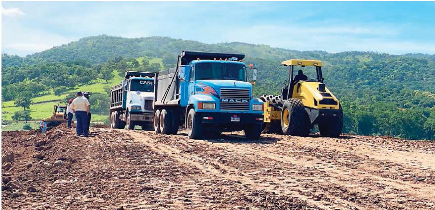
Las autoridades de la CCIVS aseguraron que con condiciones climatológicas favorables estarían terminando la obra en un mes.
