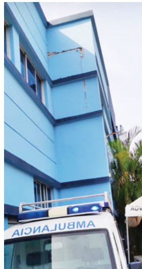
El Cuerpo de Bomberos inspeccionó el edificio del Seguro Social en donde hubo desprendimiento de repello de una de las paredes.
