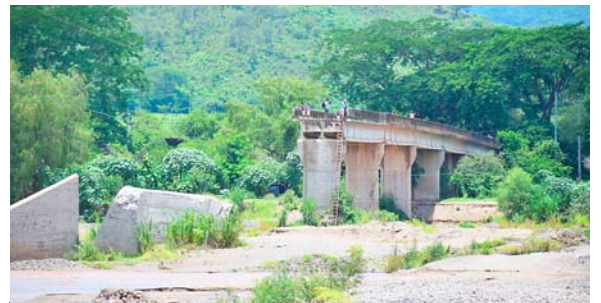
El puente fue destruido por las tormentas Eta y Iota. Durante 9 meses solo han recibido promesas de apoyo, pero nada concreto.
