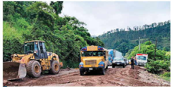
Después de 9 horas de bloqueo, maquinaria pesada removió escombros entre La Entrada y Copán Ruínas.
