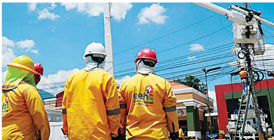
Informes en manos de la Comisión Interventora señalan que EEH no ha sido capaz de reducir las pérdidas y tampoco ha ejecutado las inversiones programadas.
