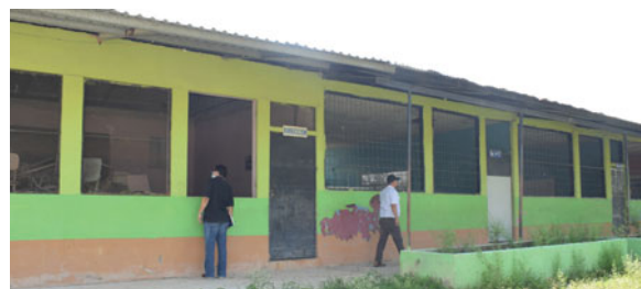
El centro básico Rafael Pineda Ponce es uno más que está en el abandono. Su muro perimetral fue destruido por Eta y Iota.
