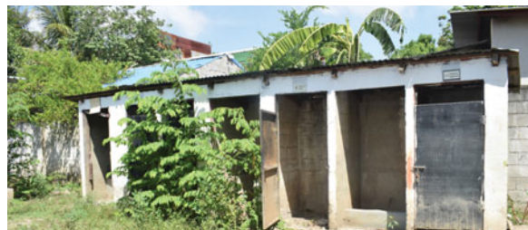
Los sistemas de alcantarillado de muchos centros educativos necesitan ser reconstruidos desde cero.
