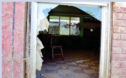
En la zona norte muchos edificios de centros educativos quedaron dañados por Eta y Iota, pero en otras partes del país el daño se debe a la falta de mantenimiento.
