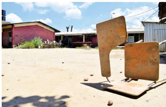
Las deficiencias en infraestructura son solo parte del problema. Unos 14,000 edificios escolares presentan problemas en paredes y techos a nivel nacional.
