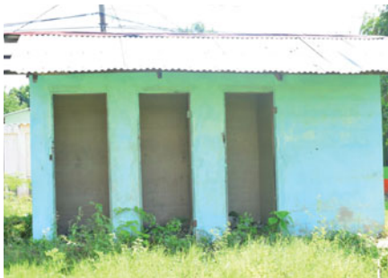
Muchas escuelas, como esta de Cerrito Lindo, tienen sus sistemas de agua potable y alcantarillado completamente inservibles.
