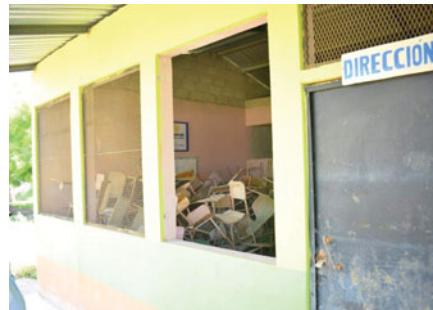
Muchas oficinas y aulas permanecen como bodegas para pupitres en mal estado.
