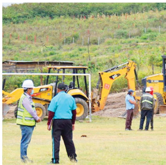
En el proyecto Lomas del Diamante se construirán viviendas para los damnificados de las tormentas Eta y Iota en la capital.
