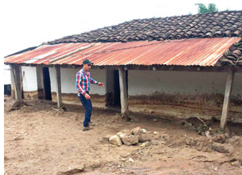
El alcalde Miguel Ángel López supervisa una de las casas afectadas. Nótese la altura a la que quedó el techo y como el lodo ya había bajado de nivel.
