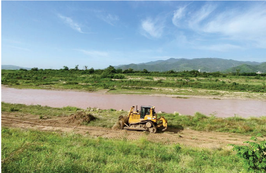
Los trabajos de reparación del bordo en el sector Chamelecón inició ayer, adelantando así la labor que habían previsto comenzar el próximo lunes.
