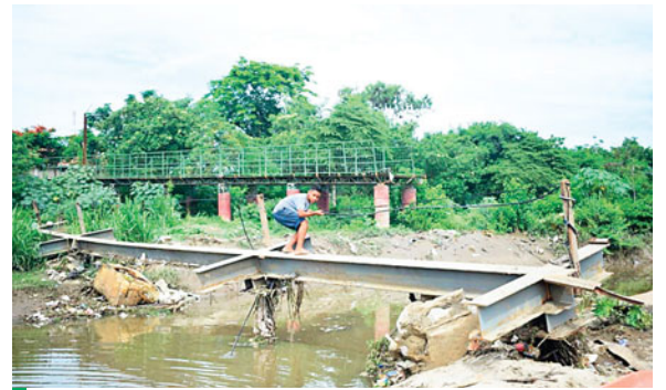
Algunos habitantes utilizan este material de hierro que ha quedado en cerca de donde estaba el puente, les sirve para cruzar hacia el otro extremo.
