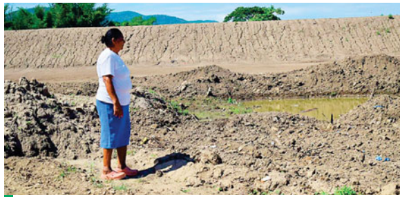
Doña María Gómez va todos los días al bordo y aseguró que pasa pendiente porque hace unos días hubo lluvias leves y esa fue la causa de las grietas.
