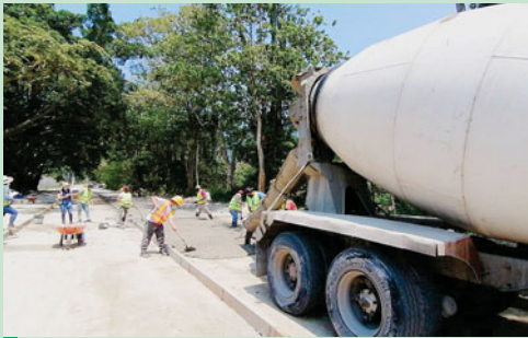
El proyecto consiste en la pavimentación sobre el bordo sur del río Santa Ana, desde la intersección con el bulevar Jardines del Valle, finalizando en el puente de Panorama.
