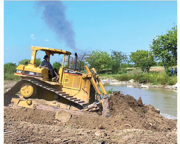
Actualmente se está trabajando en varios bordos que resultaron dañados por las tormentas.
