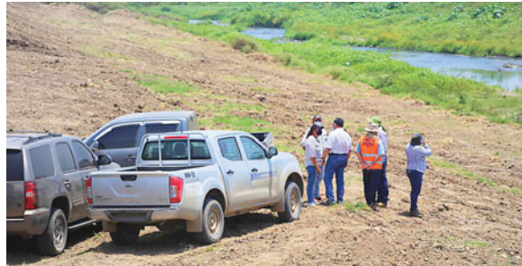
Entes encargados de llevar a cabo el proyecto de reconstrucción de los bordos inspeccionan las zonas para conocer en detalle sobre los trabajos que realizarán.
