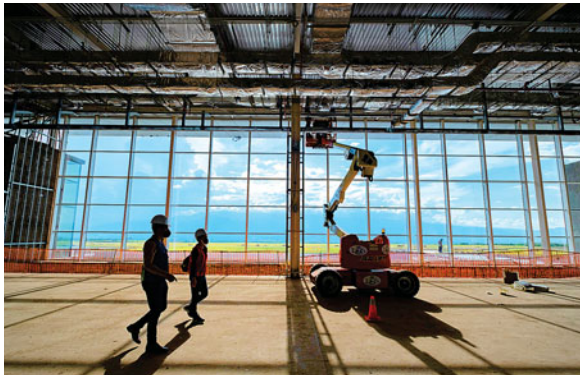
Los trabajadores se enfocan actualmente en detalles, como las partes eléctricas y aires acondicionados.
