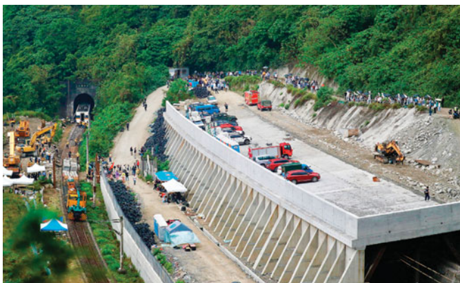
El tramo accidentado se restablecerá el 20 de abril en vez del día 8, como se había previsto inicialmente.
