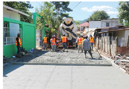
Recientemente se inició el proyecto de pavimentación en la colonia La Unión del sector Dos Caminos.
