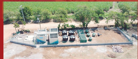
Alcantarillado sanitario y tratamiento de aguas.
