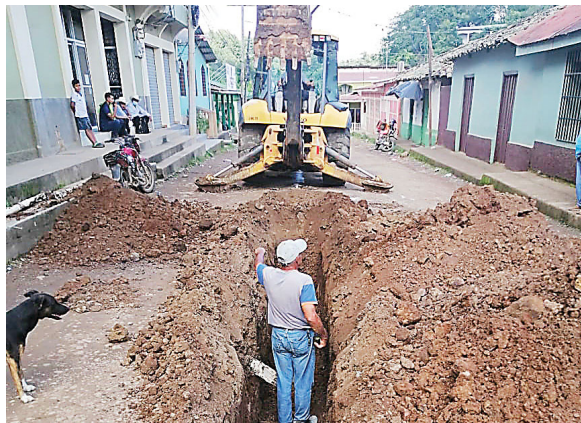
Maquinaria trabajando en el casco urbano para instalar tuberías de agua potable.
