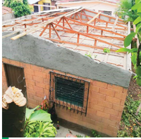
Entre las principales reparaciones en las casas después de las inundaciones, son la de los techos, paredes, pisos y sistema eléctrico.
