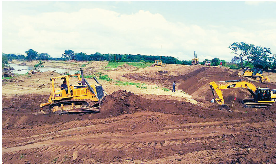
La puesta en marcha de los 10 proyectos, protegerá a miles de ciudadanos de futuras inundaciones.
