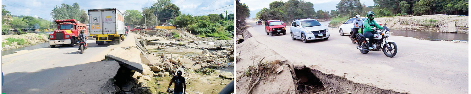
El paso de las recientes tormentas tropicales ocasionaron un deterioro considerable en esta transitada vía.
