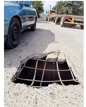
Transeúntes indican que la cantidad de hoyos, pone en peligro la seguridad más que todo de motociclistas. Piden mejor alumbrado público.
