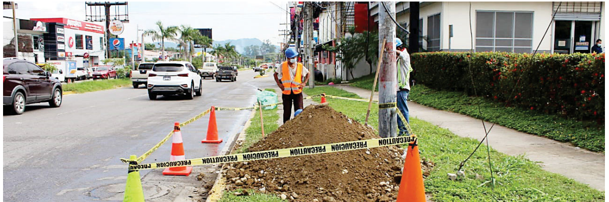
Los trabajos de semaforización permitirán una mejor movilidad en el tráfico vehicular.
