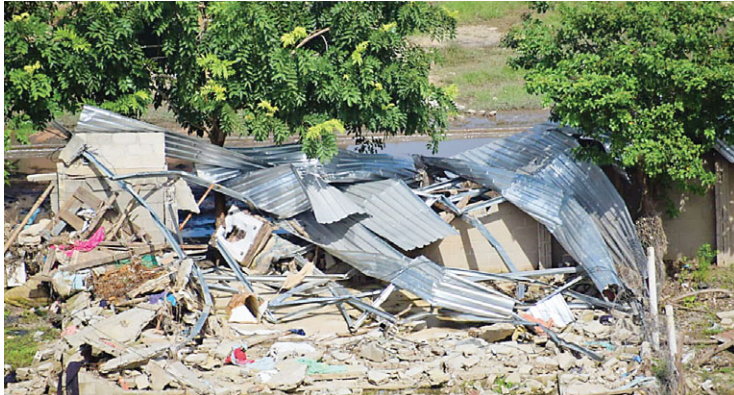
Algunas viviendas se destruyeron por completo, los dueños no tienen esperanza de regresar pronto debido a la magnitud de los daños.
