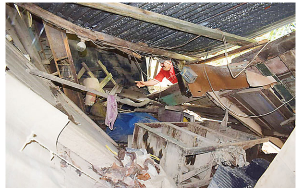
Varias casas colapsaron y aún no han podido realizar limpieza, las cosas dañadas continúan adentro.
