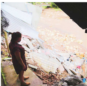
Equipos de Gobierno constataron los daños generados por el desbordamiento del río Copán.
