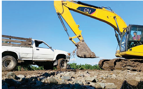
Maquinaria pesada ya trabaja en apoyo a la comunidad y en labores de rehabilitación de calles. Esto es en Banderas.
