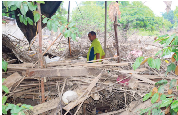
Luis Cruz recuerda con mucha tristeza el taller que tenía en el patio de su casa, solo los escombros le quedaron.
