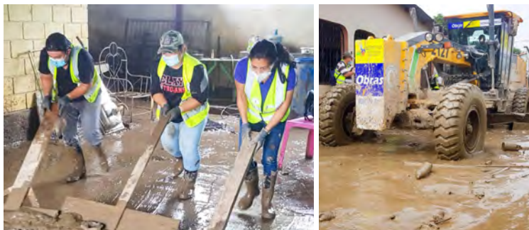
El lodillo es una de las dificultades con las que se han enfrentado los dueños de viviendas, el uso de maquinaria hace efectivo los trabajos en los pasajes.
