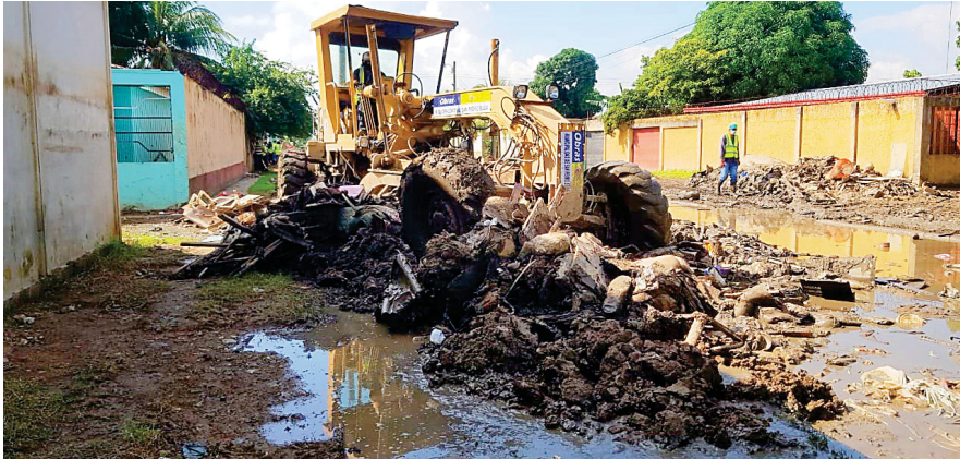
Equipos sacan escombros y lodo de los pasajes y calles a fin de habilitar el libre paso de los habitantes y conductores.
