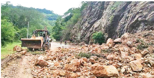
Maquinaria ya trabaja en rehabilitar pasos en carreteras secundarias en santa Bárbara.
