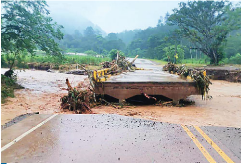
Daños en los cabezales del puente en Las Malvinas, carretera internacional.
