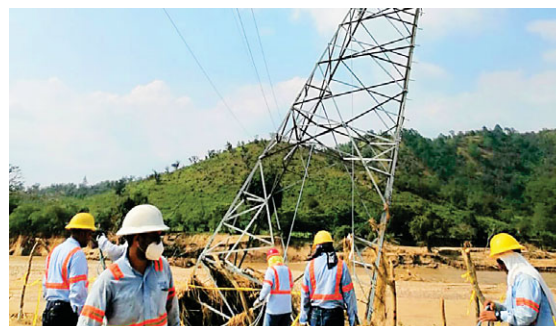
Los daños de las tormentas se hicieron sentir a nivel nacional, con mayores impactos en la costa norte.
