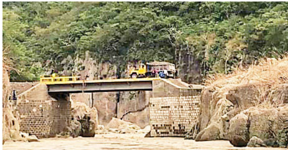
Los daños en la red vial fueron cuantiosos, pero ya el gobierno emprendió su rehabilitación.
