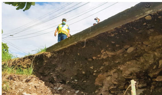
Es evidente el daño que sufrieron las vías que sirven de alivio de tráfico para los conductores.
