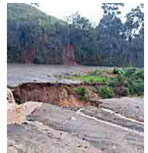
El municipio de Trojes, El Paraíso, quedó nuevamente aislado por daños en las carreteras.
