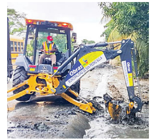
las calles, para evitar la obstrucción de las tuberías.
