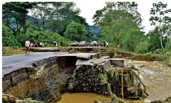
Una gran cantidad de carreteras han quedado destruidas producto de las inundaciones.
