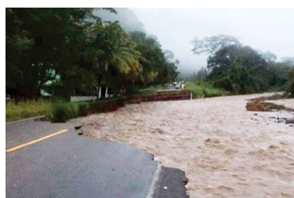
Petoa, Santa Bárbara, se interrumpió el paso hacia la cabecera.
