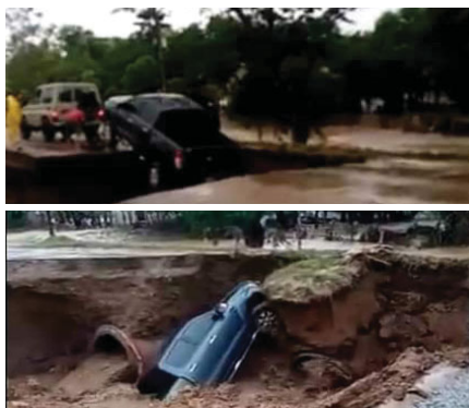
El conductor de este pick up intentó pasar sobre una caja puente en mal estado y terminó en un agujero que se abrió en la carretera.
