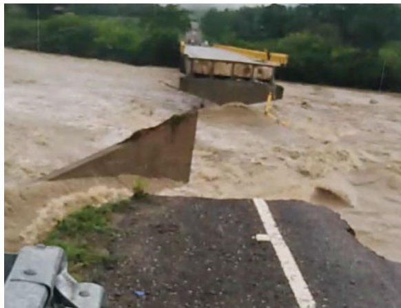
Uno de los muchos puentes destruidos. Está sobre el río San Marcos, entre Olanchito y Jocón, en Yoro.
