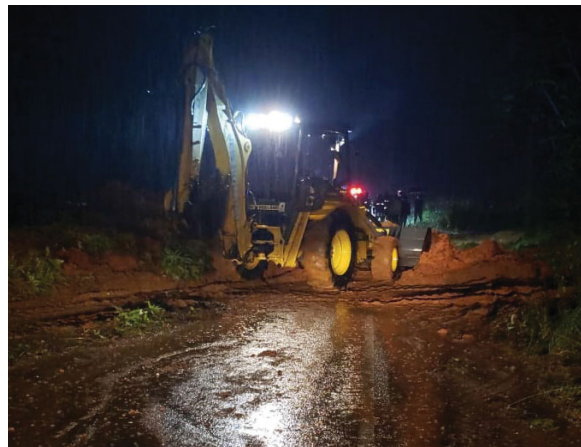
Anoche un derrumbe interrumpió el paso entre Omoa y la frontera con Guatemala.
